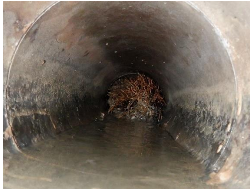
図 1 木の根が管路を狭窄している例
